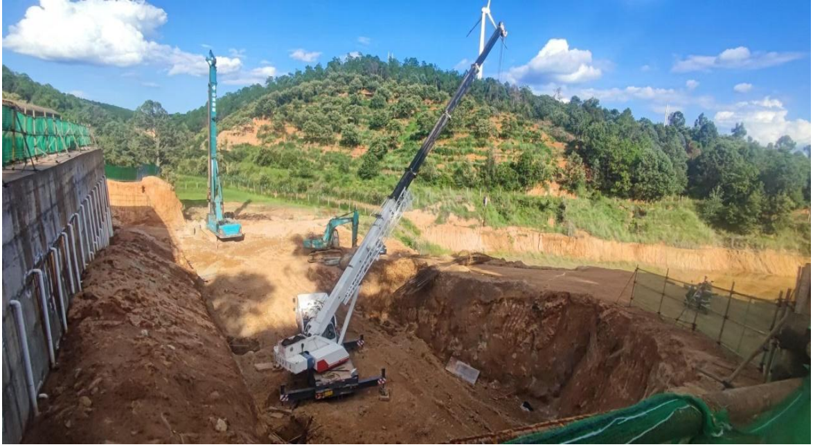
图 2 事故发生现场图
